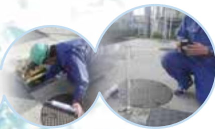
塩素剤の補給 汚泥の調整・移送
