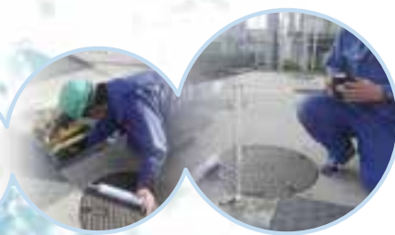
塩素剤の補給 汚泥の調整・移送
